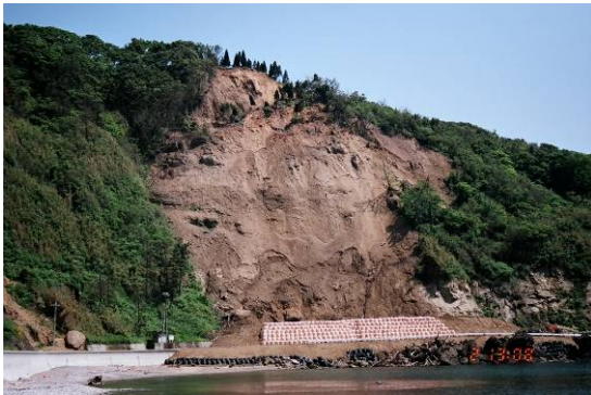
写真 4.9 市道沿いの深層崩壊（S-13）
