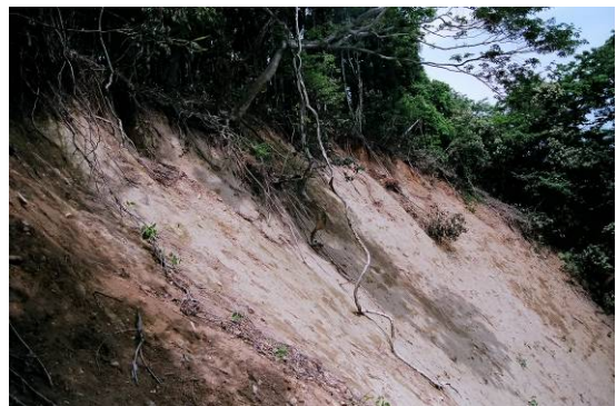
写真 4.36 表層崩壊の頭部
