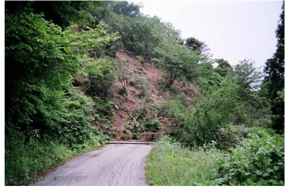
写真 4.40 地すべり崩土が崩落 (S-38)
