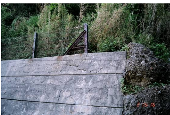
写真 4.16 一部が損傷した背後斜面の擁壁 （S-31, コンクリート擁壁にクラック発生）
