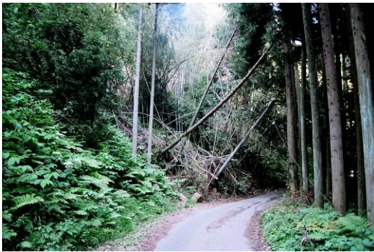
写真 4. 37 市道沿いの表層崩壊（地すべり地形の滑落崖, S-33）
