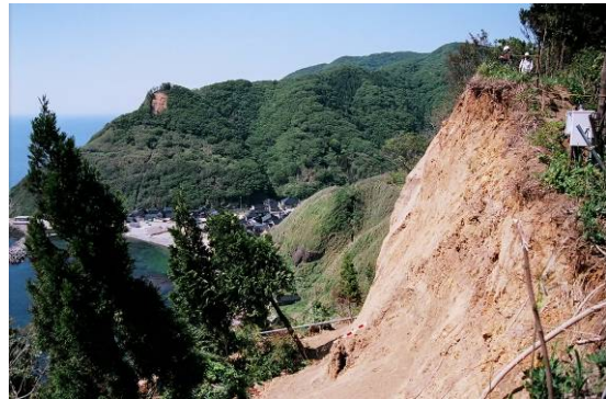
写真 4.10 深層崩壊の滑落崖
