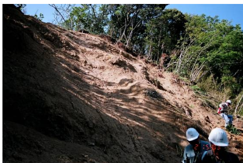
写真 4.18 表層崩壊の状況
