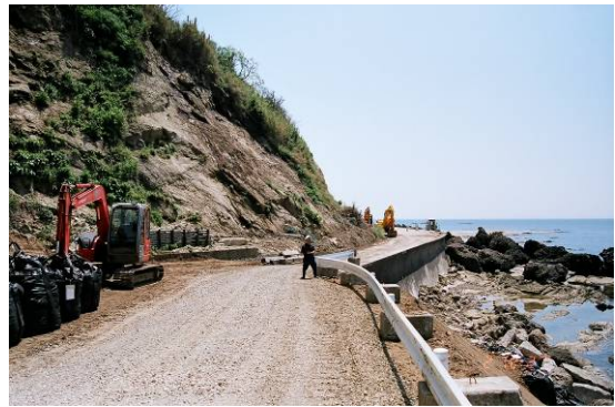
写真 4.6 崩土が取り除かれた市道
