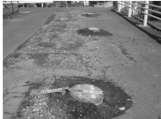
写真1 沈下により道路に突き出た抑止杭
