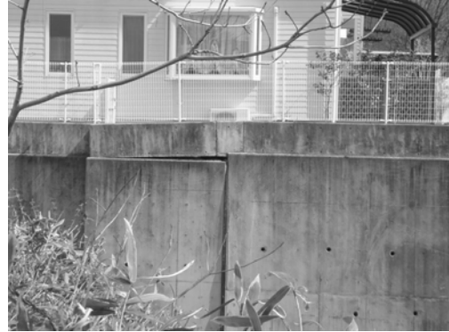
写真6 擁壁部の沈下程度の変状のみ
