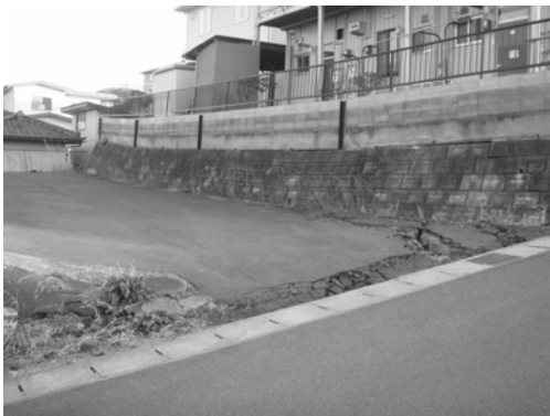
写真4 変動により擁壁が撓んでいる
