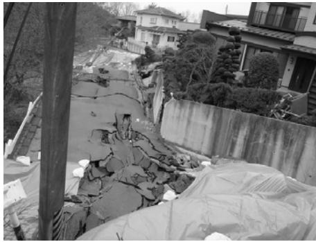
写真9 南側ユニットの崩壊
