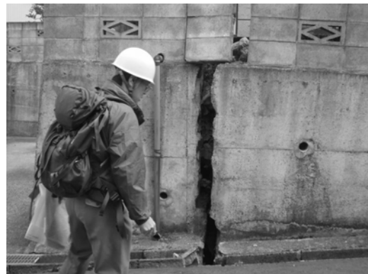
写真2 盛土ユニット境界部の引張クラック
