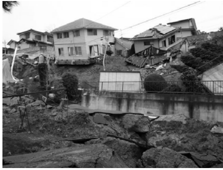
写真8 大規模な盛土崩壊
