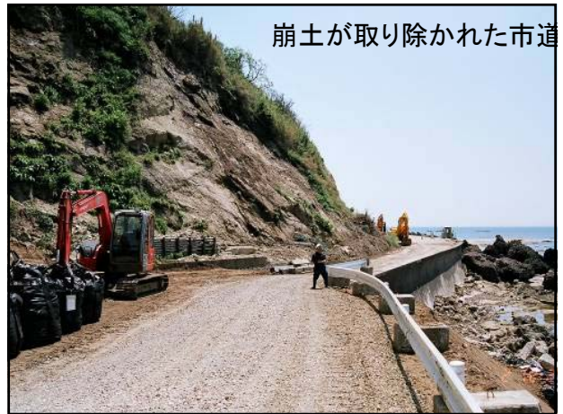
市道沿いの斜面崩壊
