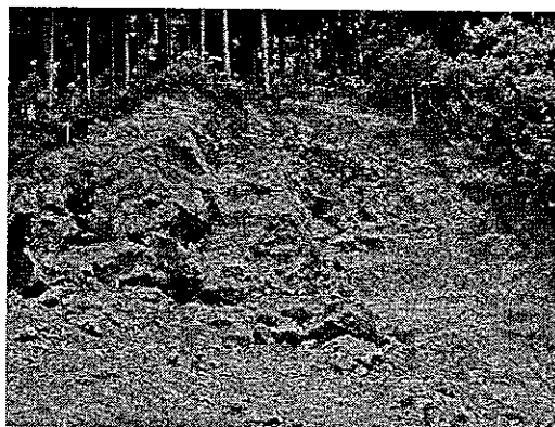
写真-3 崩壊上部の岩盤崩壊部分
