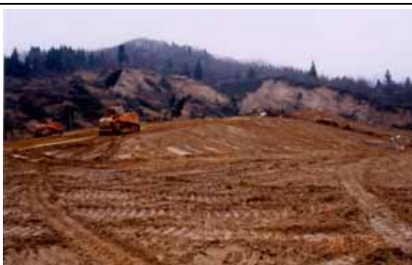
地すべり土塊の二次移動防止のための切土施工 (東竹沢地すべり土塊頭部における切土状況)
