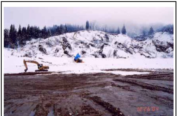
地すべり土塊の二次移動防止のための切土施工(東竹沢)
