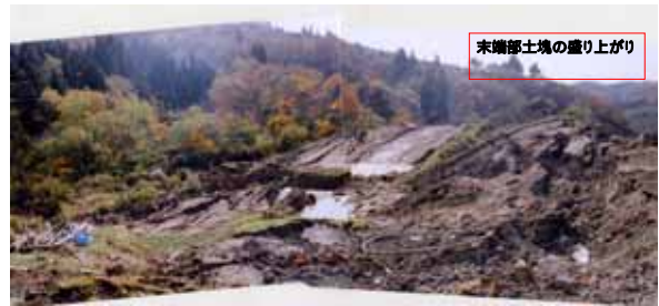
東竹沢地すべり末端部の状況(11月3日撮影)
