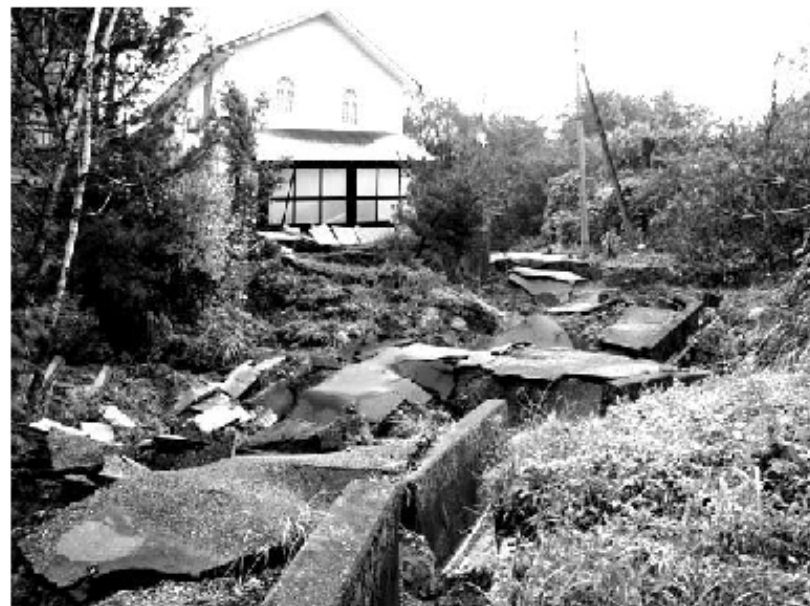
写真 3 谷埋め盛土の地すべり（中越地震）
