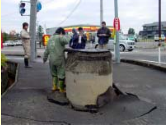
マンホールの浮き上がり (小千谷市)
