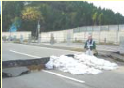
盛土の沈下による段差
