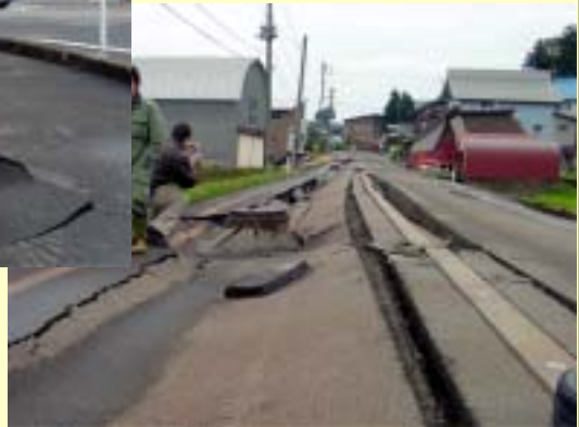
埋め戻し部の陥没 (小千谷市)
