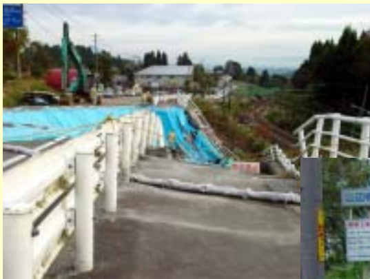
沢部の盛土崩壊(天納) 国道17号線
