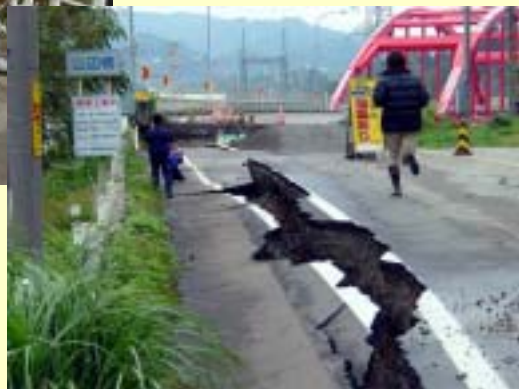
橋梁と盛土の段差(山辺橋) 国道117号線
