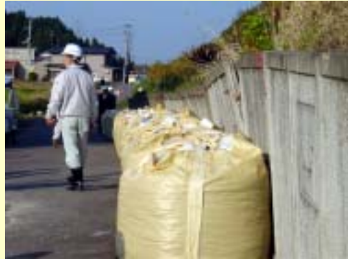
盛土のはらみだし
