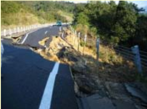
沢部の盛土が崩壊(川口町)
