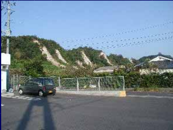
国道220号宮脇地区
