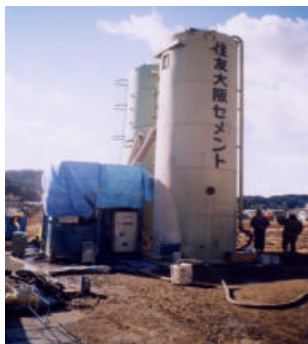
プラント全景 ・セメントサイロ：30t ・フライアッシュサイロ：30t
