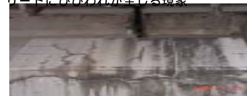
アルカリ骨材反応による損傷
