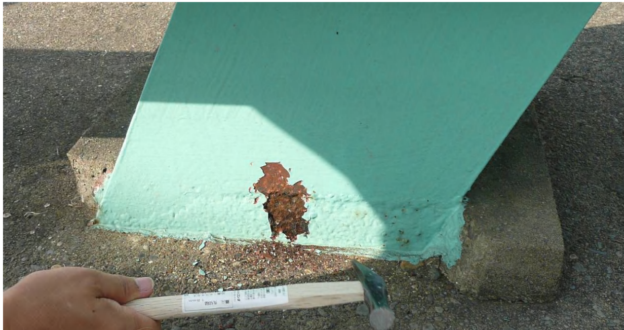
さびの上に塗装を行った例
