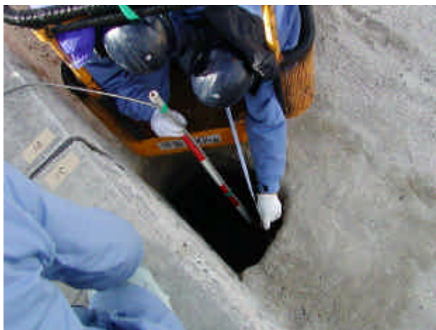
東側突堤 №14-15 ケーソン目地部
