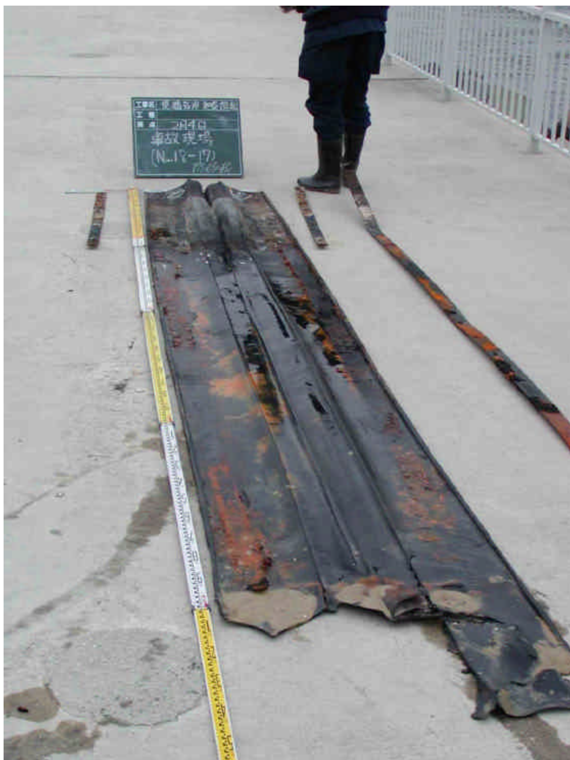
写真-3.5 事故箇所 No.17-18 防砂板
