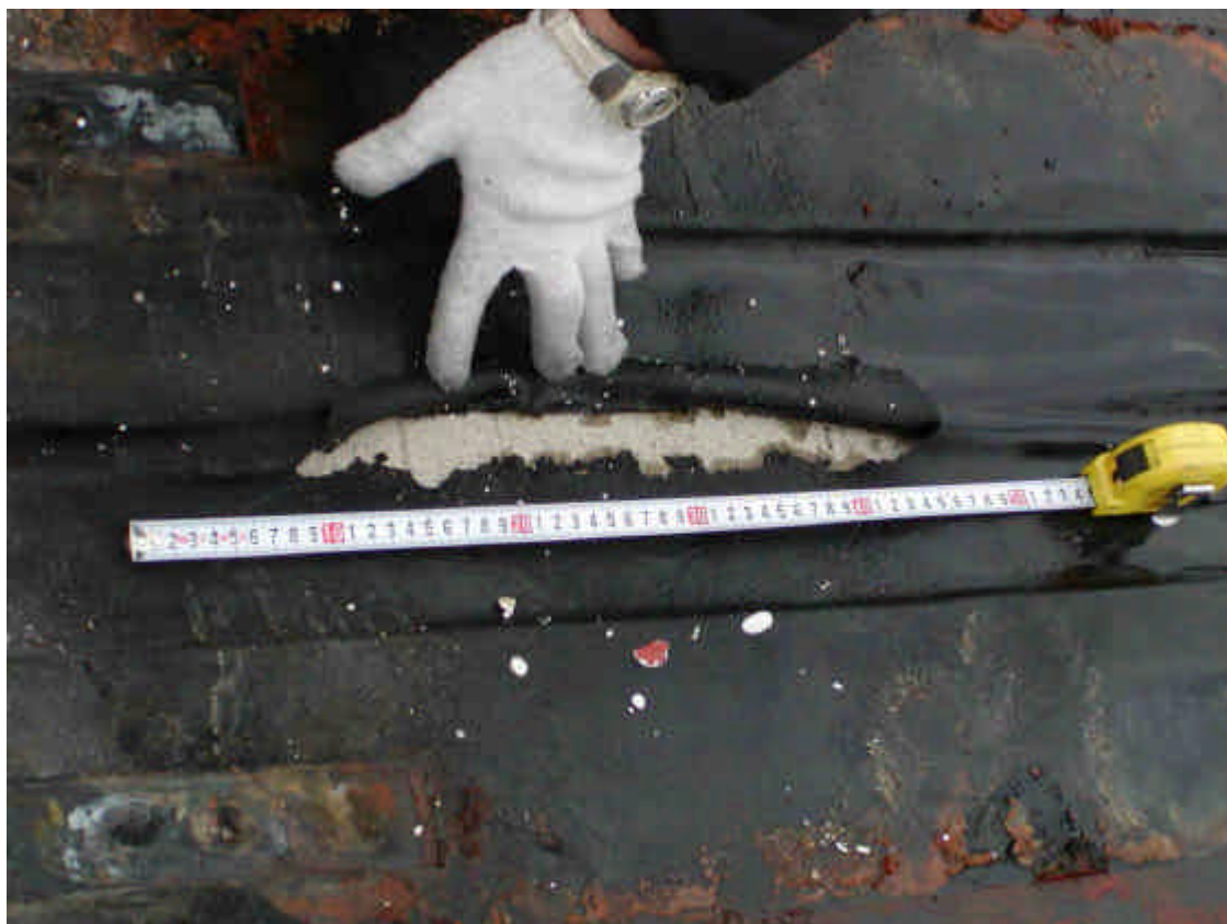
写真－3.6 事故箇所 No.17-18 防砂板の破損状況
