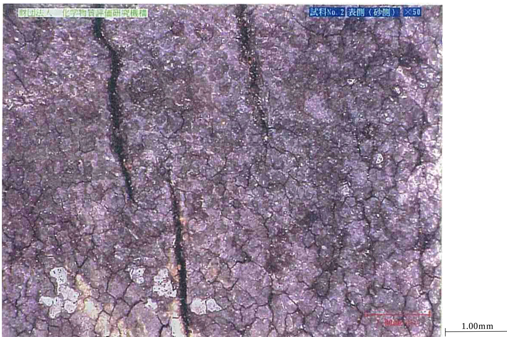
写真-3.8 ケーソン No.11-12 防砂板表面の拡大写真（陸側表面 海面より上部）
