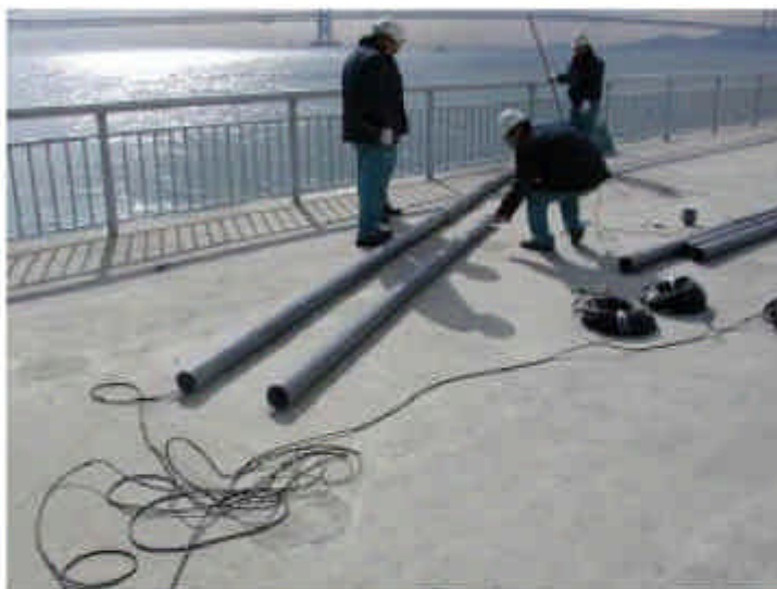
陸側水位計測用 ストレーナー
