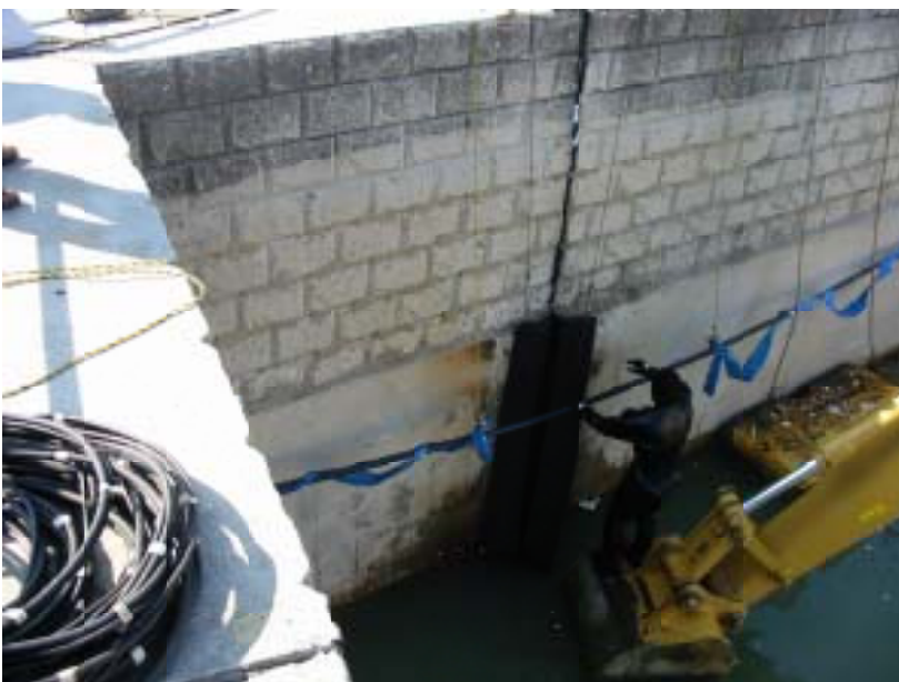
加速度計を取付た 防砂板の設置状況
