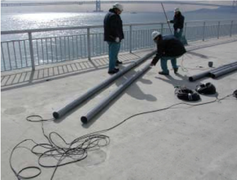
陸側水位計測用 ストレーナー
