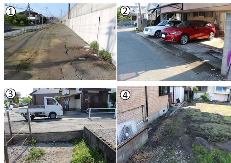
図 3. A. 2 南高江地区における液状化被害
