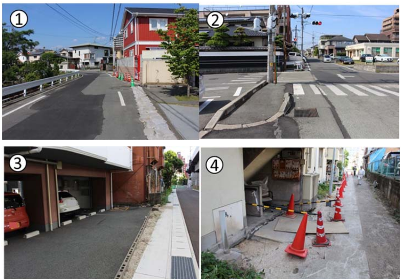
図 3.A.9 横手・島崎地区における液状化被害
