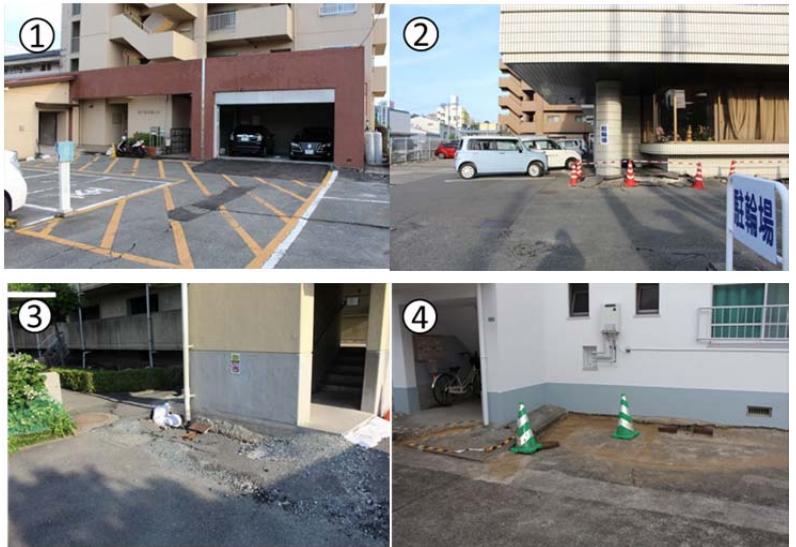
図 3.A.8 花園・上熊本地区における液状化被害
