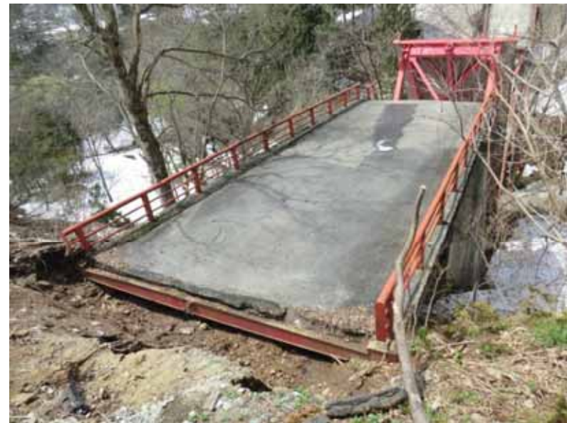
写真-12 国道側から(栄大橋側)青倉部落側を撮影
