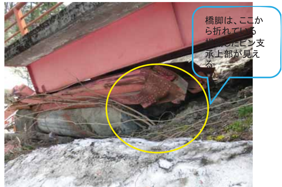
写真-6 谷方向へ折れた橋脚と挟まったトラス部材
