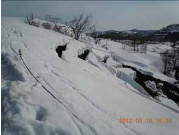
写真-24 源頭部 ( ) 源頭部ではさらに崩壊の可能性あり
