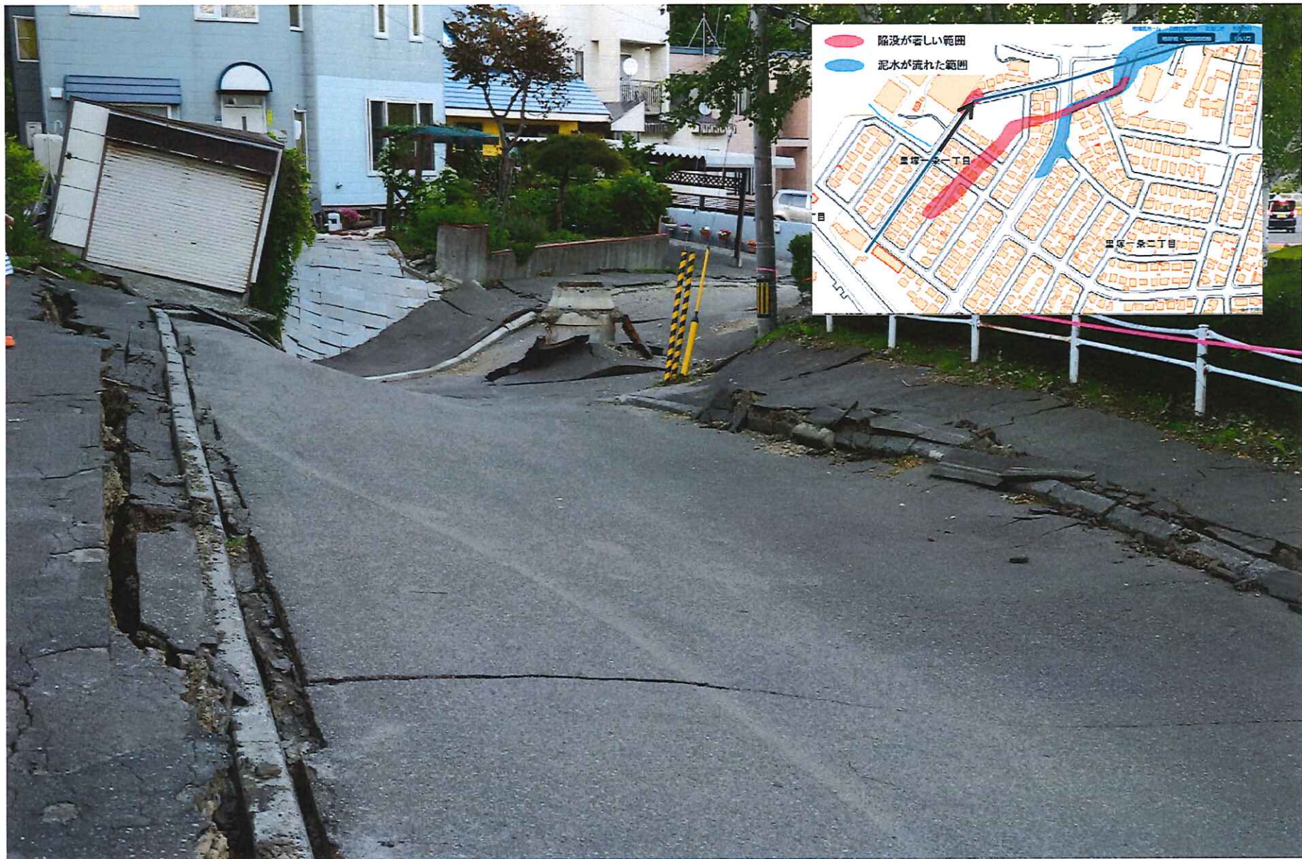
河川暗渠上での著しい陥没. 液状化で流動化した土砂が河川暗渠に沿って流出したと考えられる(河川暗渠は損傷なし).
