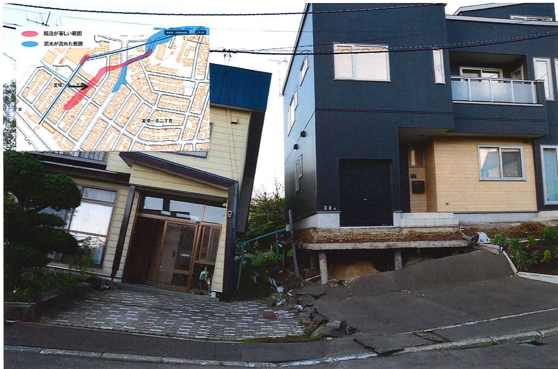
带状の陥没エリア上の家屋。杭基礎を有する右の家屋は傾きが小さい。 地盤は1.5m程度陥没。
