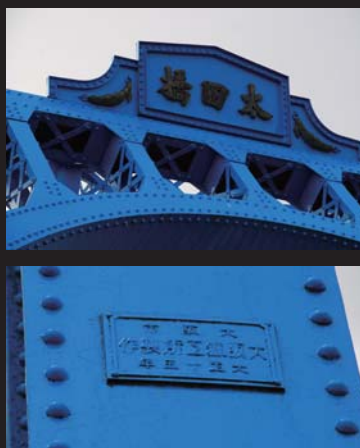
銘板「大阪市大阪鉄工所制作大正十五年」
