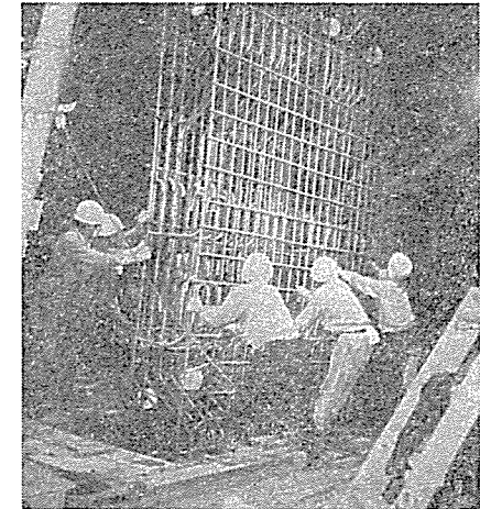
写真-4.8 イコス工法実施状況 (側壁鉄筋かごの吊下げ) 1961年、営団施行
