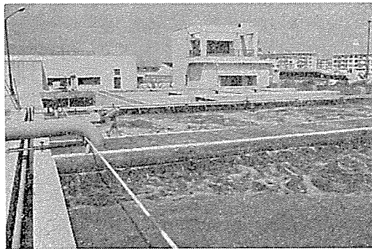
写真—4.14 (a) 住宅団地における処理場
